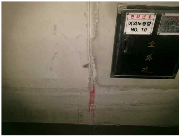
RAMP-C NATM구간 측벽부 S19 보수부 박락
