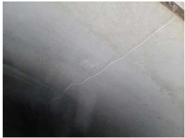
본선 NATM구간 천단부 S320 균열(Cw=0.5mm)
