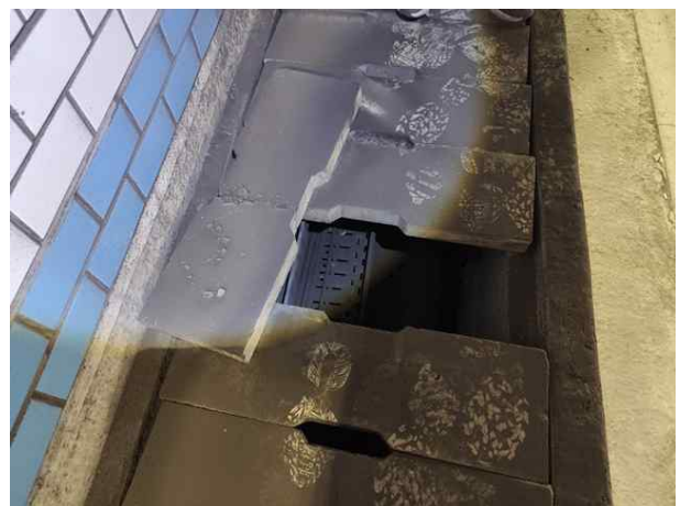
본선 공동구 S393 덮개파손
