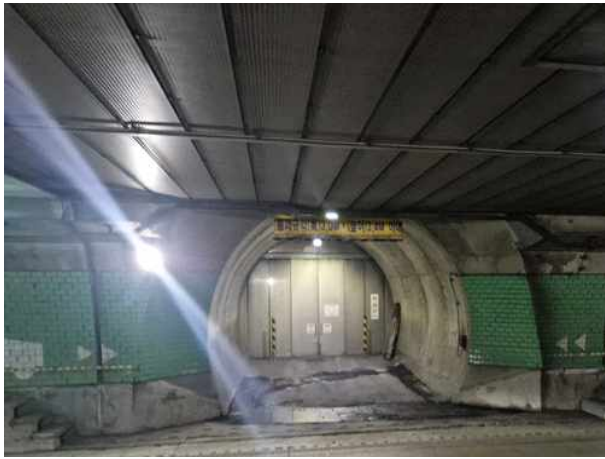
피난연락갱 S566 누수(떨어짐)
