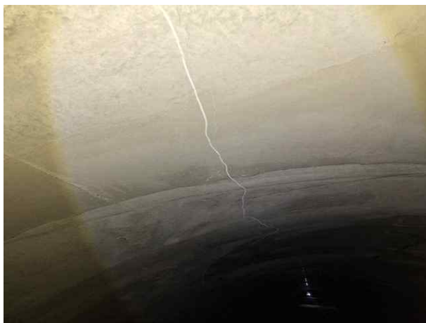
본선 NATM구간 천단부 S208 균열(Cw=0.5mm)
