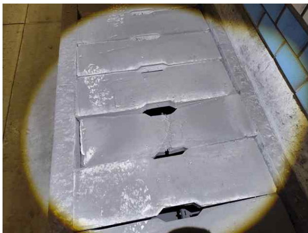
본선 공동구 S602 덮개파손
