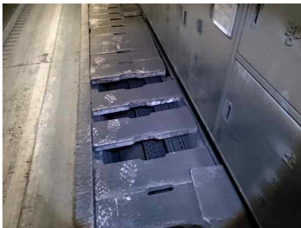
본선 공동구 S350 덮개파손
