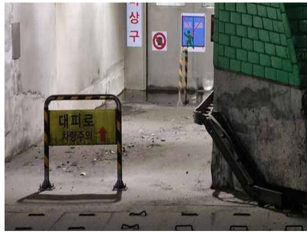
피난연락갱 S062 누수(떨어짐)
