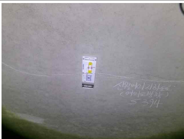
본선 NATM구간 천단부 S394 균열(Cw=0.5mm)
