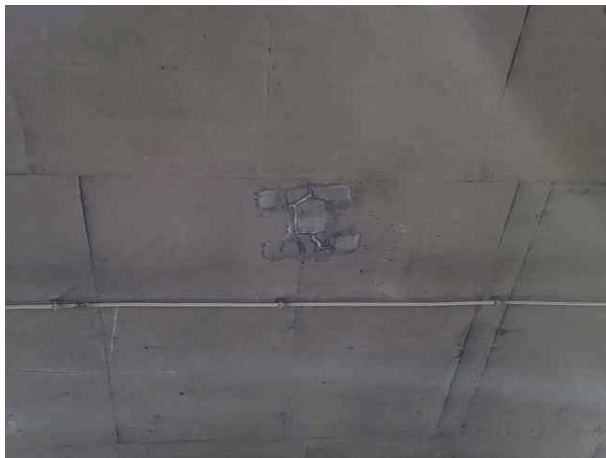
RAMP-C BOX구간 슬래브 S03 백태
