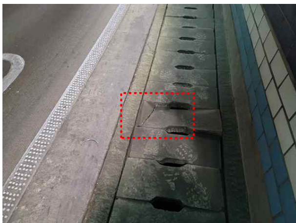
RAMP-C 공동구 S67 덮개파손
