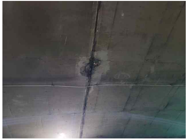
RAMP-C BOX구간 슬래브 S02 박락
