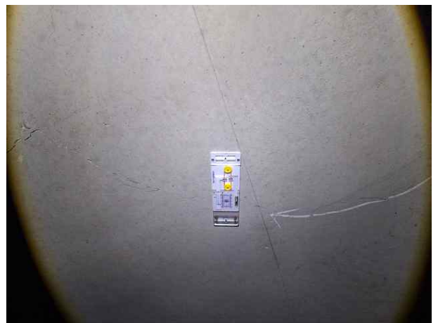
본선 NATM구간 천단부 S234 균열(Cw=0.5mm)
