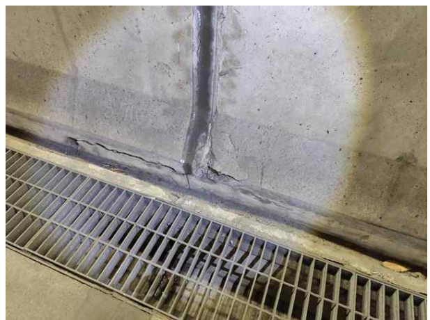
본선 공동구 S717 파손
