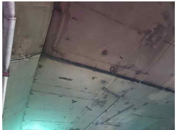
RAMP-C BOX구간 슬래브 S03 누수(스며있음)
