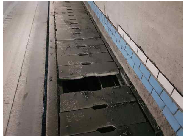
본선 공동구 S214 덮개탈락
