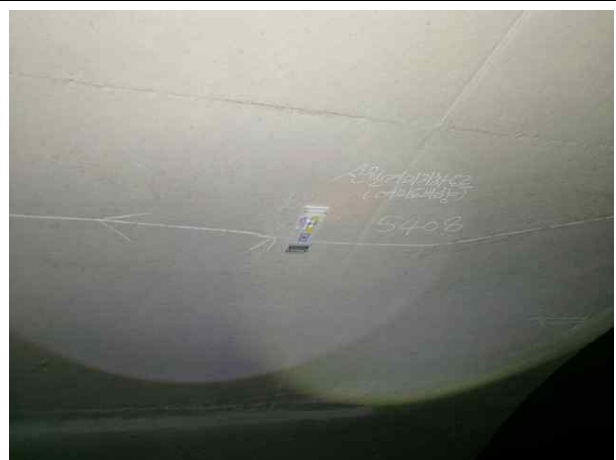
본선 NATM구간 천단부 S408 균열(Cw=0.5mm)
