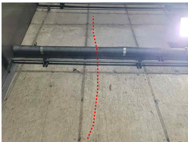
RAMP-C 환기실(S09) 벽체 균열(Cw=0.3mm)
