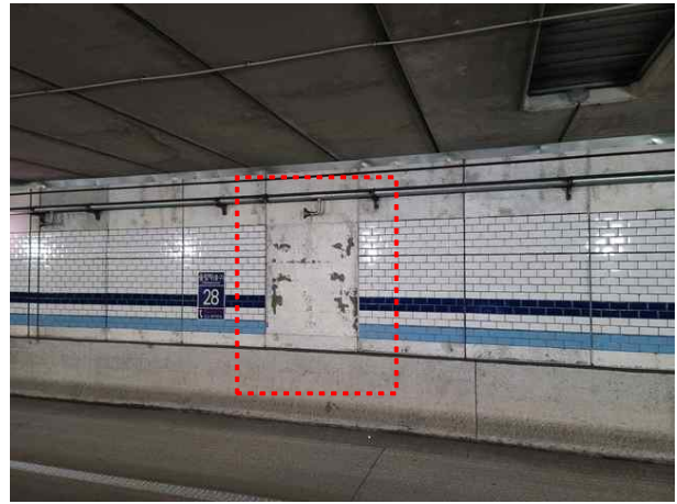
RAMP-C NATM구간 측벽부 S63 타일탈락
