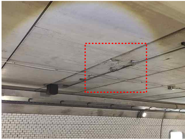
본선 S663 신호기 파손
