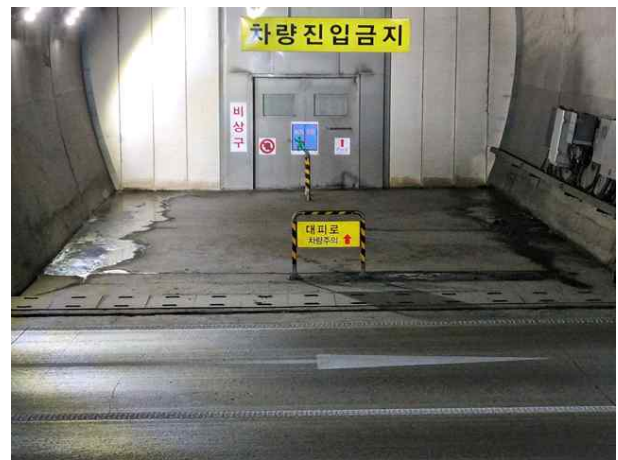
피난연락갱 S165 누수(떨어짐)
