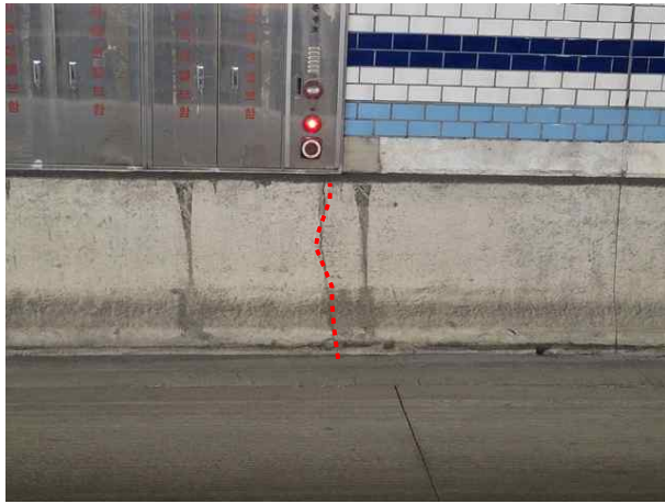
RAMP-C 공동구 S10 균열(Cw=0.5mm)
