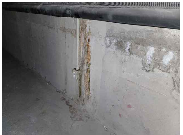
RAMP-C 전기실 측벽부 누수
