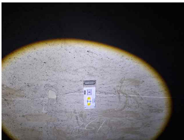
본선 NATM구간 천단부 S261 균열(Cw=0.5mm)
