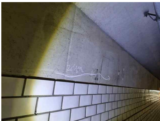
본선 NATM구간 측벽부 S267 균열( Cw=0.2mm )
