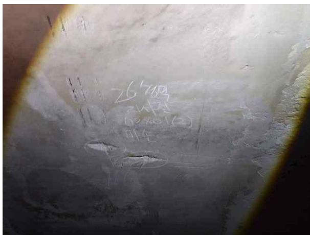
본선 NATM구간 천단부 S710 파손
