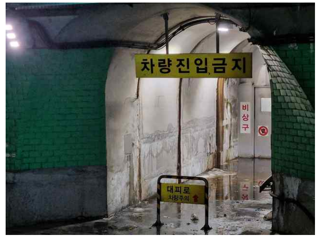
피난연락갱 S127 누수(떨어짐)
