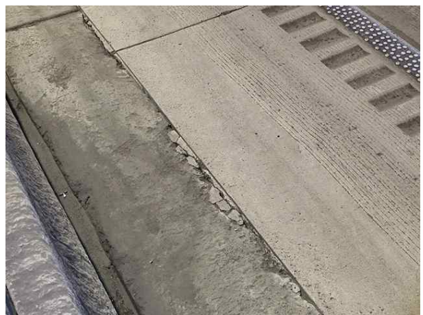
본선 포장부 S513 파손
