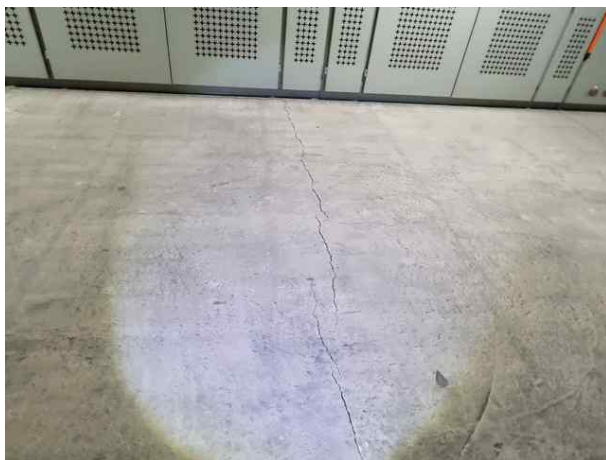
전기실 S715 바닥 망상균열
