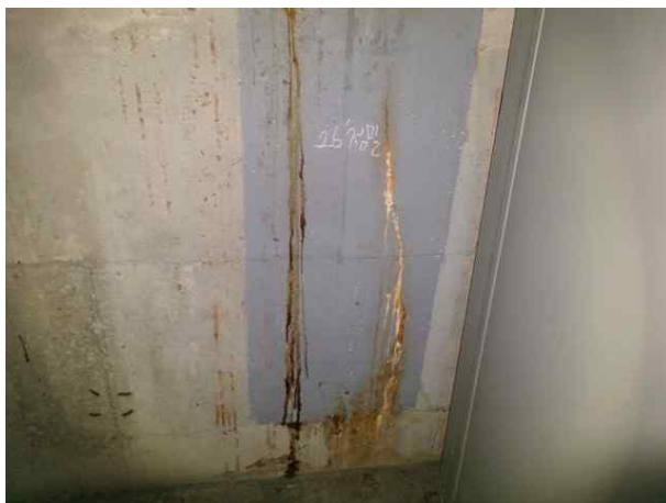
RAMP-C 전기실 측벽부 보수부 백태
