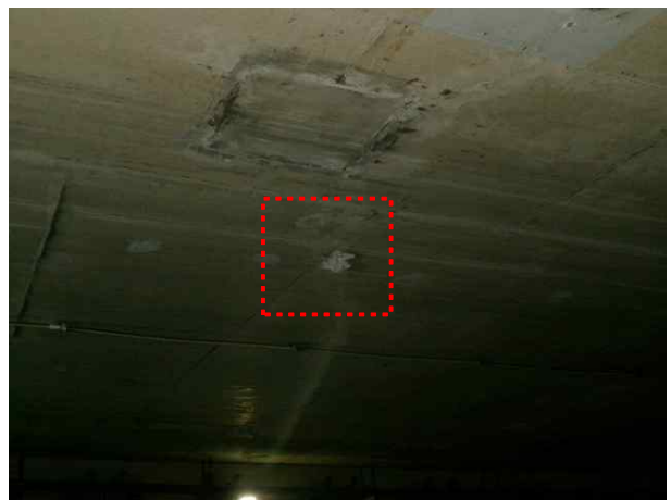
본선 BOX구간 슬래브 S723 백태
