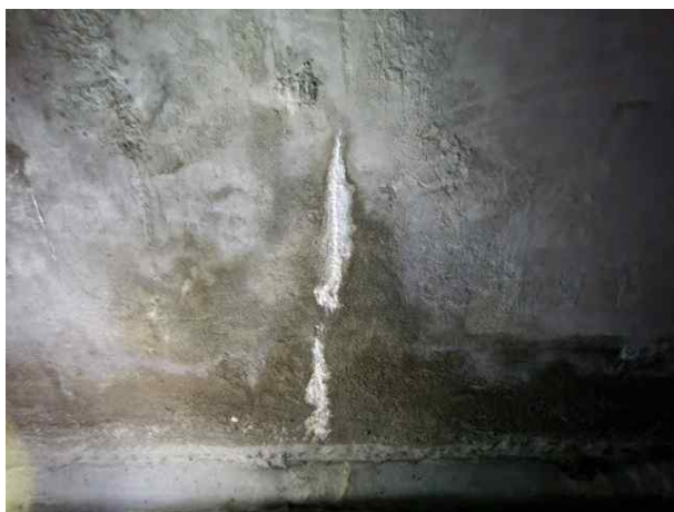
공기정화시설#2 축류팬실 측벽부 누수
