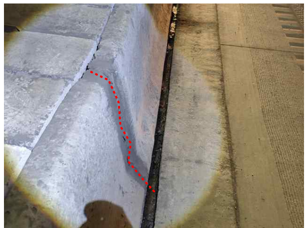
본선 공동구 S687 균열(Cw=0.3mm)
