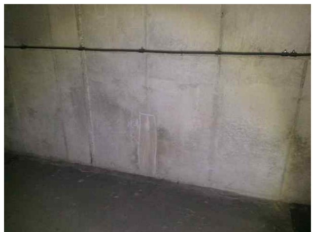
RAMP-C 수문 벽체 백태
