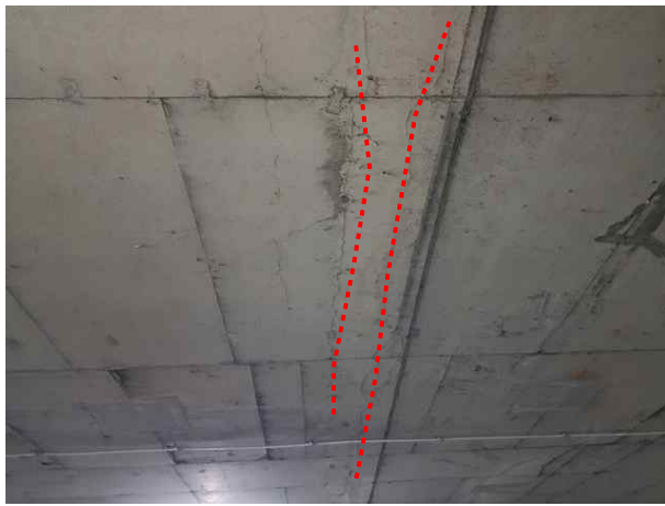
본선 BOX구간 슬래브 S002 균열(Cw=0.2mm)
