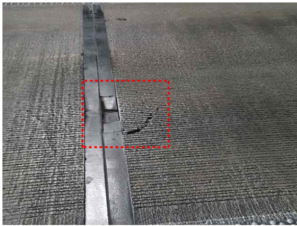
RAMP-C 포장부 S01 파손, 로드셀 파손
