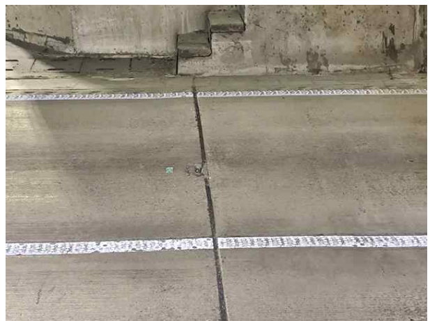
본선 포장부 S690 파손
