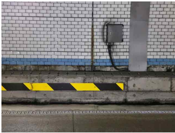
본선 NATM구간 측벽부 S156 균열( Cw=0.3mm ) 및 누수(스며있음)
