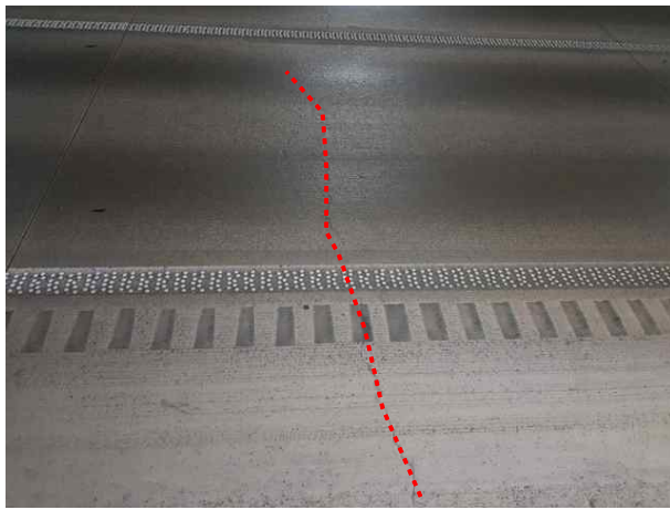
본선 포장부 S326 균열
