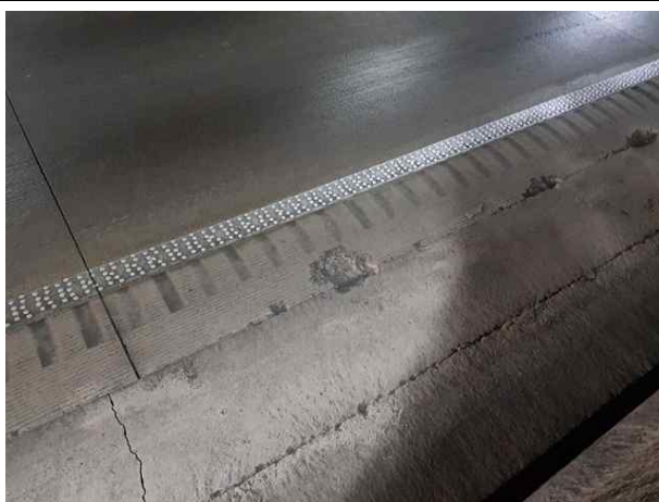
본선 포장부 S222 파손
