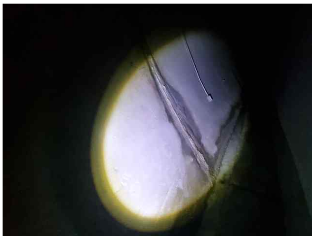
공기정화시설#2 축류팬실 측벽부 누수
