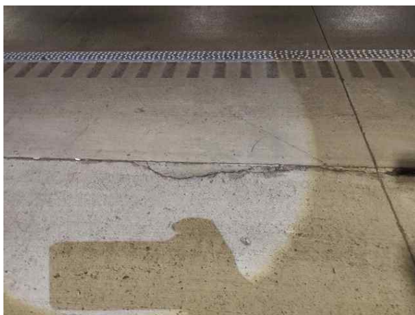
본선 포장부 S417 파손
