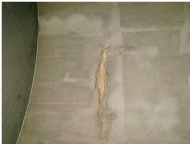
공기정화시설#2 연직갱연결횡갱 측벽부 백태
