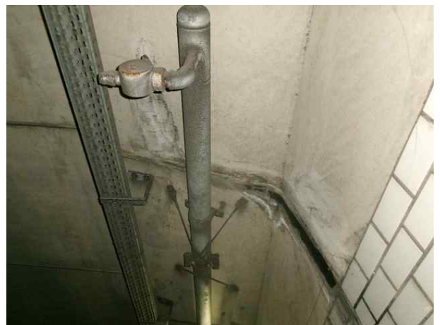
본선 NATM구간 측벽부 S620 균열( C_w=0.3\text{mm} ) 및 누수(스며있음)
