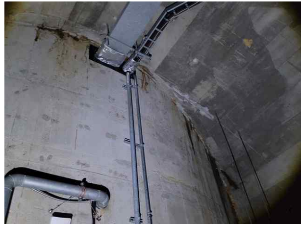
공기정화시설#2 연직갱연결횡갱 천단부 균열( C_w=0.3\text{mm} ) 및 누수(스며있음)
