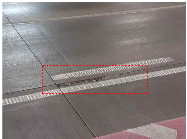
본선 포장부 S169 파손
