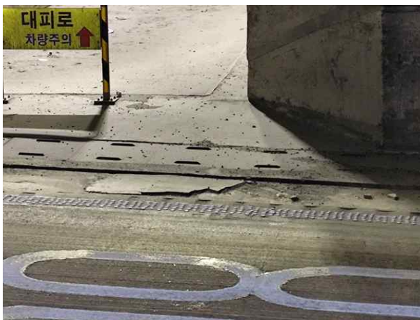
본선 포장부 S658 파손
