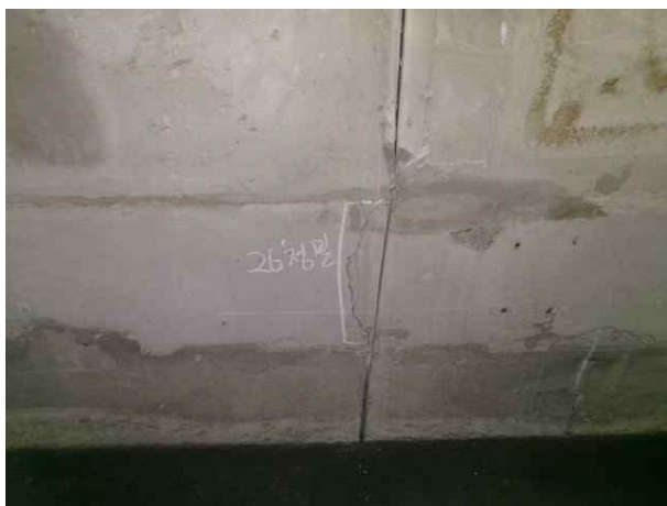
RAMP-C NATM구간 측벽부 S55 층분리
