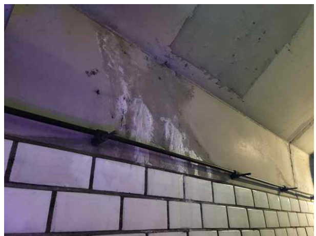
RAMP-C NATM구간 측벽부 S31 백태
