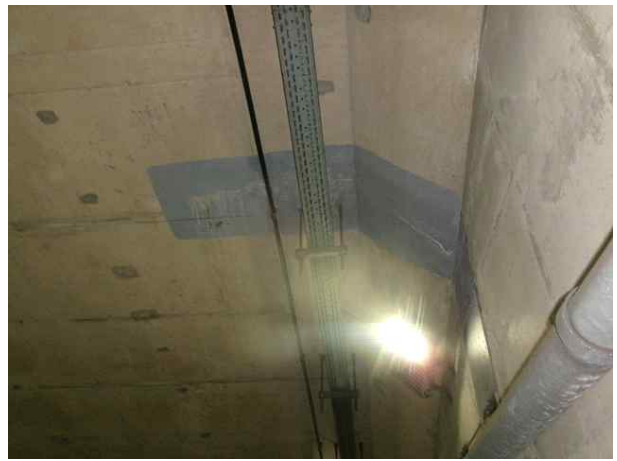
본선 BOX구간 슬래브 S716 균열부백태
