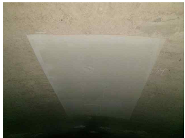
본선 NATM구간 천단부 피복부족 보수 양호
