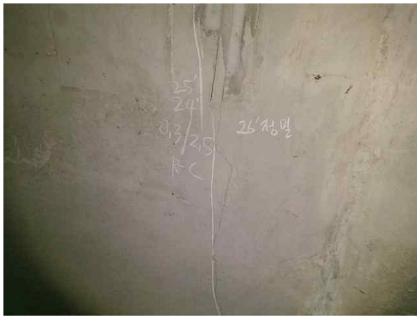
RAMP-C NATM구간 측벽부 S32 균열(Cw=0.3mm)
