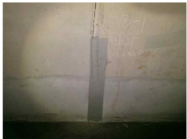
RAMP-C NATM구간 측벽부 박리보수 양호
