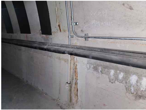
RAMP-C 전기실 측벽부 백태
