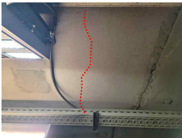
RAMP-C NATM구간 측벽부 S31 균열(Cw=0.5mm)
