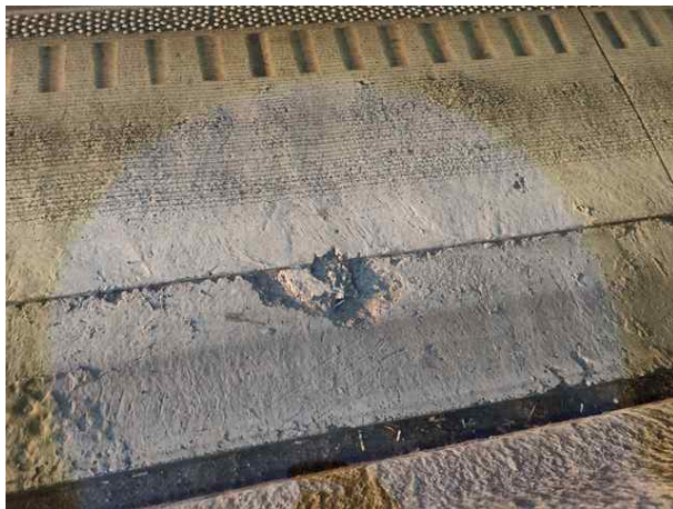
본선 포장부 S356 파손
