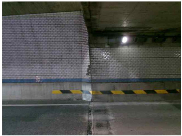
본선 BOX구간 벽체 S725 파손, 타일탈락
