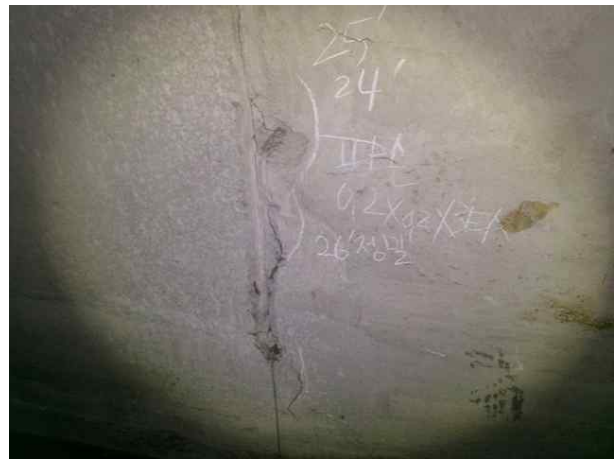
RAMP-C NATM구간 측벽부 S33 파손
