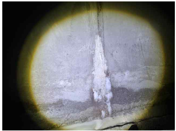
공기정화시설#2 축류팬실 측벽부 누수
