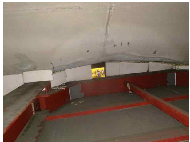
피난연락갱 S445 상부 판넬탈락
