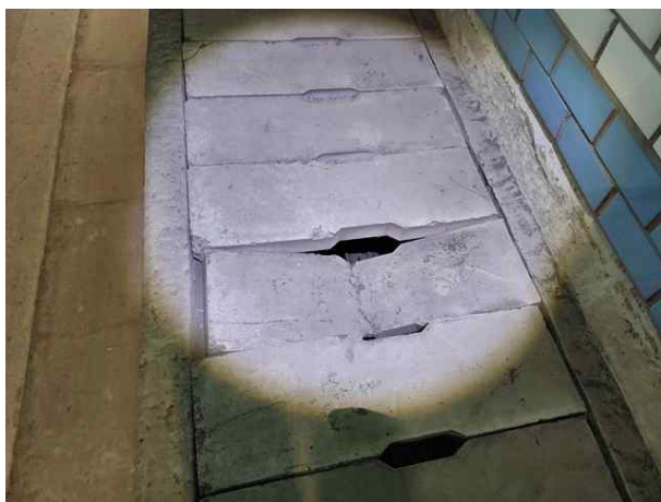
본선 공동구 S704 덮개파손
