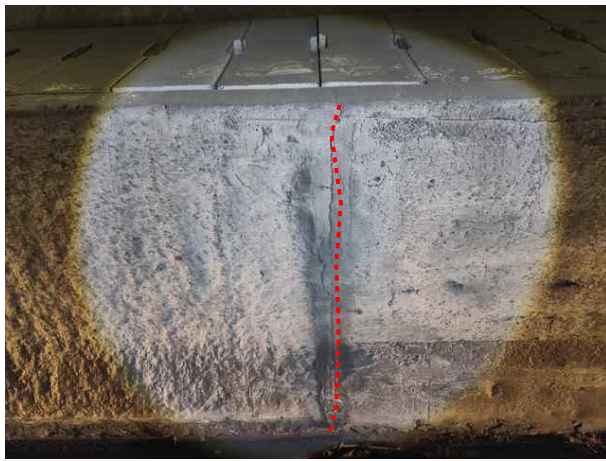
본선 공동구 S419 균열(Cw=0.3mm)
