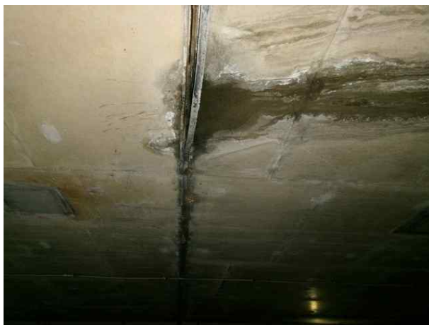
본선 BOX구간 슬래브 S721 누수(스며있음)
