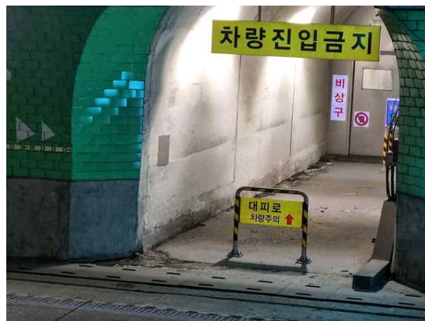
피난연락갱 S215 누수(떨어짐)
