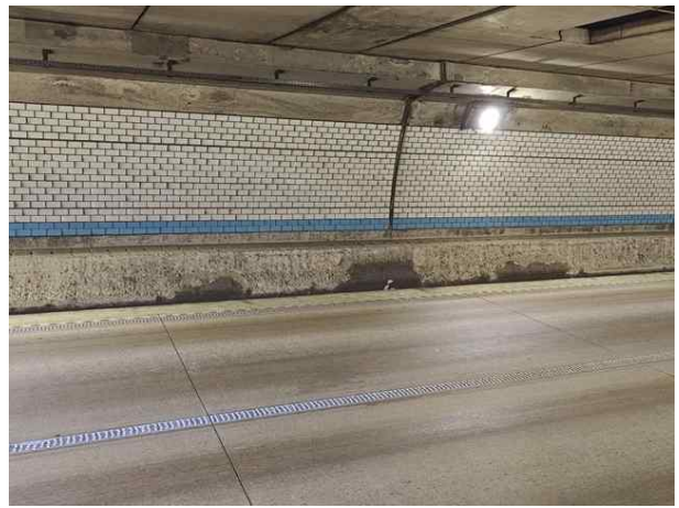
본선 공동구 S518 표면오염
