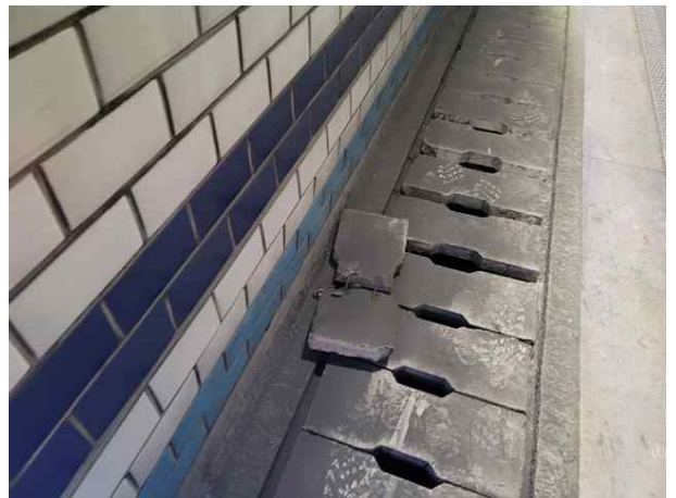
RAMP-C 공동구 S60 덮개파손
