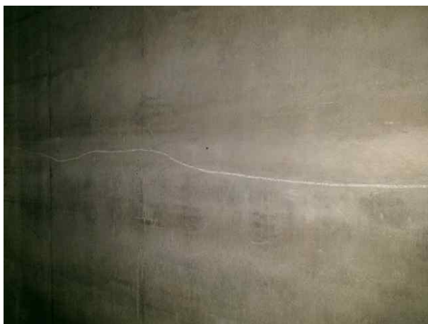
공기정화시설#2 환기탑 B5 균열( C_w=0.3\text{mm} )
