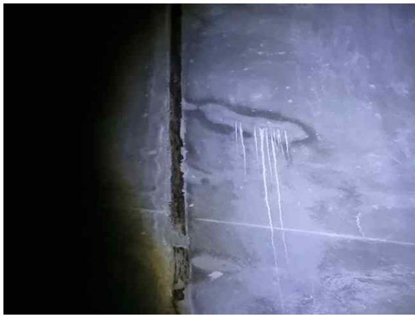
공기정화시설#2 축류팬실 측벽부 균열부백태
