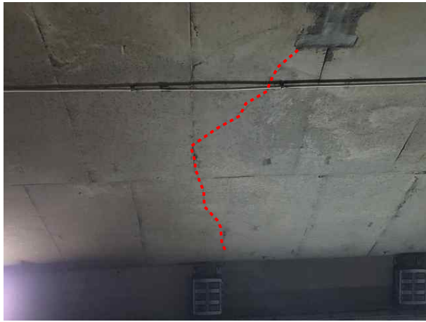
RAMP-C BOX구간 슬래브 S02 균열( Cw=0.3mm )
