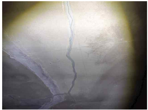
본선 NATM구간 천단부 S689 재균열(Cw=0.3mm)
