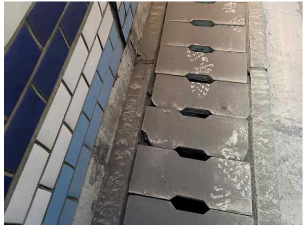
RAMP-C 공동구 S14 덮개파손
