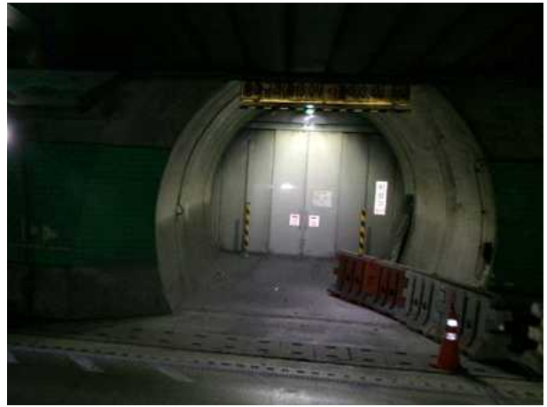
피난연락갱 S379 누수보수 양호
