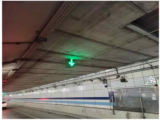
RAMP-C 신호기 상태 양호
