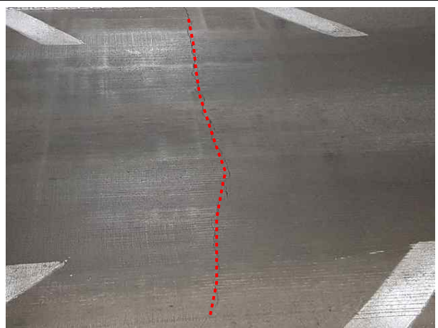
본선 포장부 S243 균열
