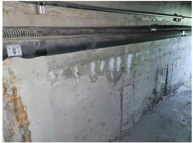
RAMP-C 전기실 측벽부 백태
