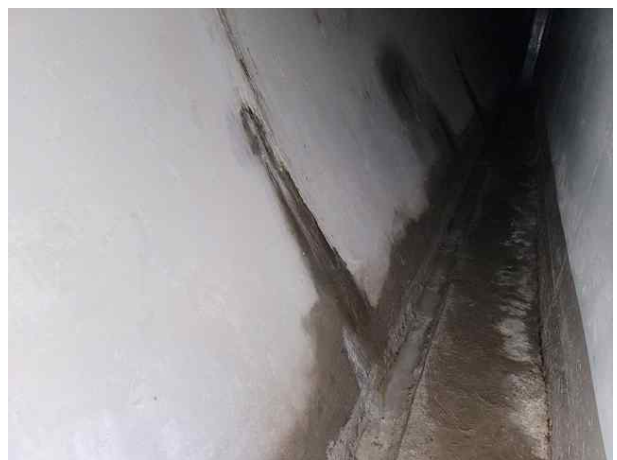
공기정화시설#2 축류팬실 측벽부 누수
