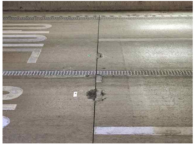
본선 포장부 S617 파손
