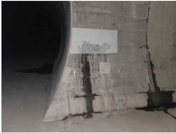
공기정화시설#2 유도갱 측벽부 균열( C_w=0.3\text{mm} ) 및 누수(스며있음)
