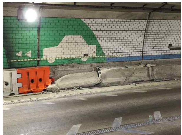
본선 공동구 S378 파손
